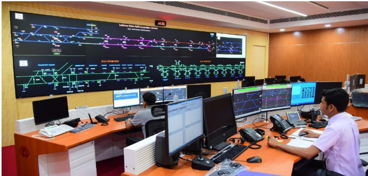
台达视讯墙安装在Lucknow捷运地铁
