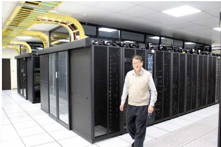
中正大学电算中心主任李新林表示，从机房规划建置到营运的经验发现，全面汰换更能提高效率且节能、省电
