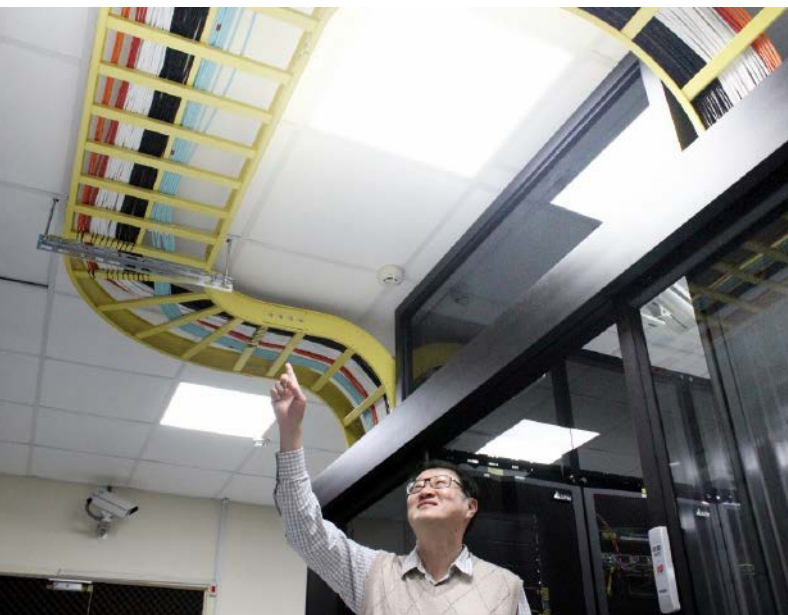
电算中心机房依不同颜色的线缆来区分用途
