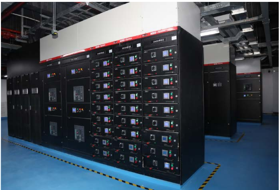
应对5A级高挑战，台达采用了专为超大规模IDC设计、引入最新科技的DPH 500kVA系列UPS，业界最高功率密度设计
