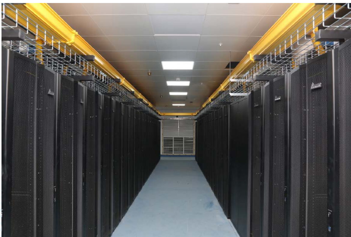
台达提供的预制微模块数据中心解决方案，在一期项目中已部署10个微模块机房
