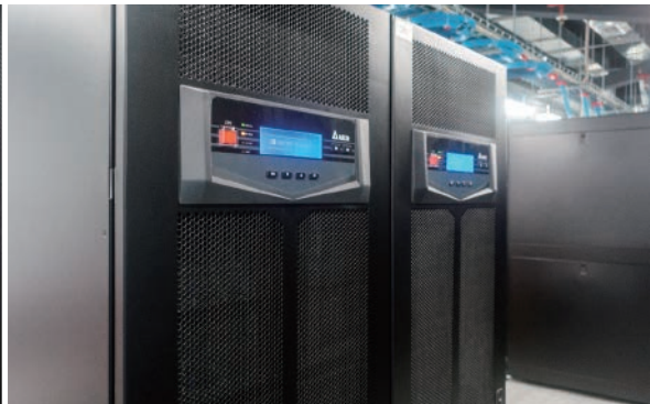
台达Ultron HPH系列在线式UPS可保护数据中心的IT设备及精密空调系统
