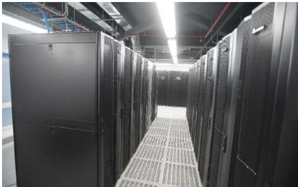
台达协助首屈一指的矿业公司建置365kW总功率容量的数据中心
