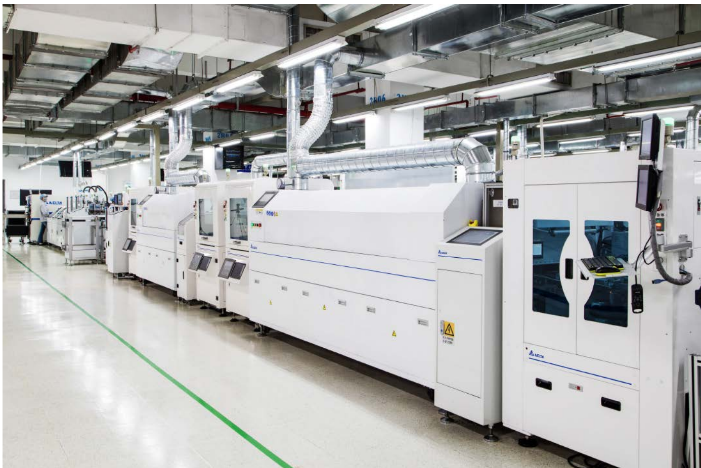
台达协助国内外面板厂建置超过100座全厂导入BCS的厂房，产线数量超过5000条，加上本身在自动化领域早已具备完整布局，让台达旗下的DIABCS深具优势
