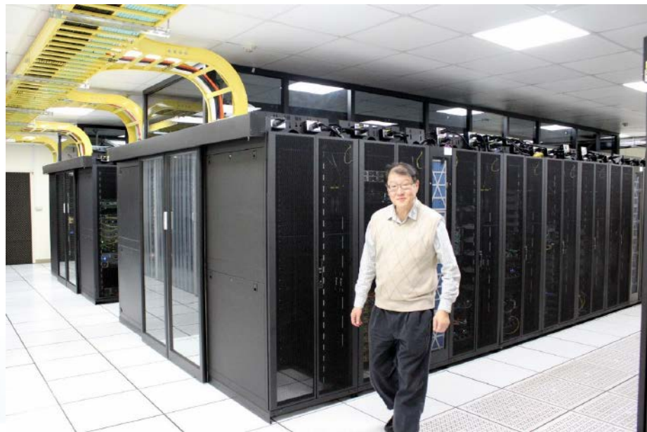
中正大學電算中心主任李新林表示，從機房規劃建置到營運的經驗發現，全面汰換更能提高效率且節能、省電
