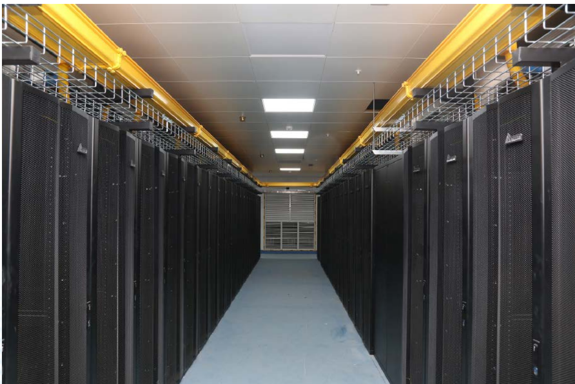
台達提供的預製微模組資料中心解決方案，在一期專案中已部署10個微模組機房
