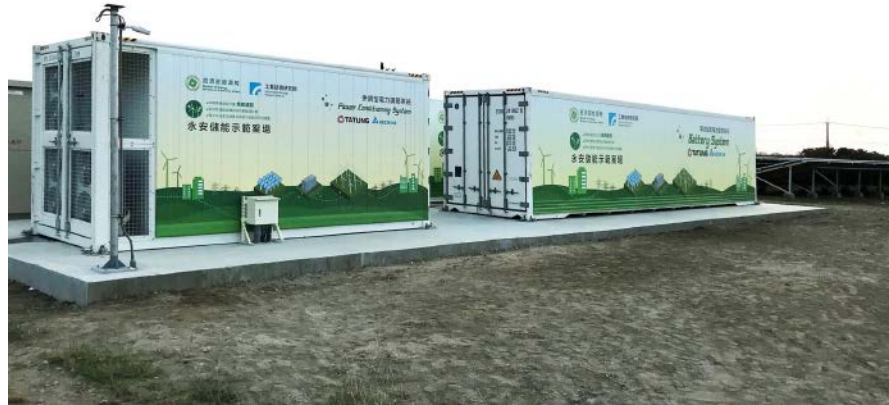
裝置於高雄永安光電廠之儲能系統
