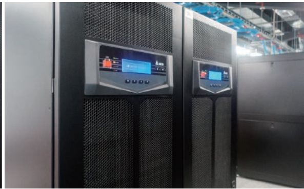
台達Ultron HPH系列在線式UPS可保護資料中心的IT設備及精密空調系統
