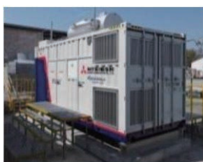
燃氣機 (Gas Engine Generator)
